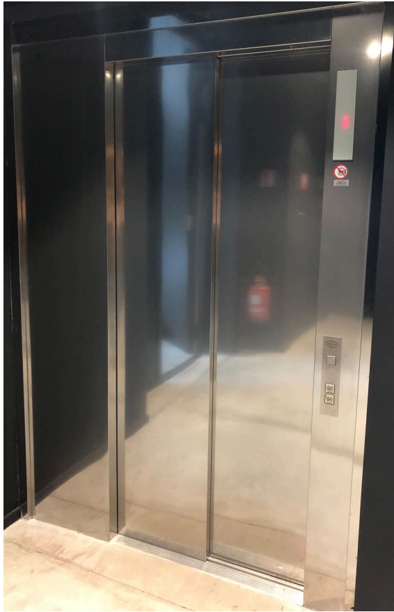
Lift naar 1 ste verdieping
