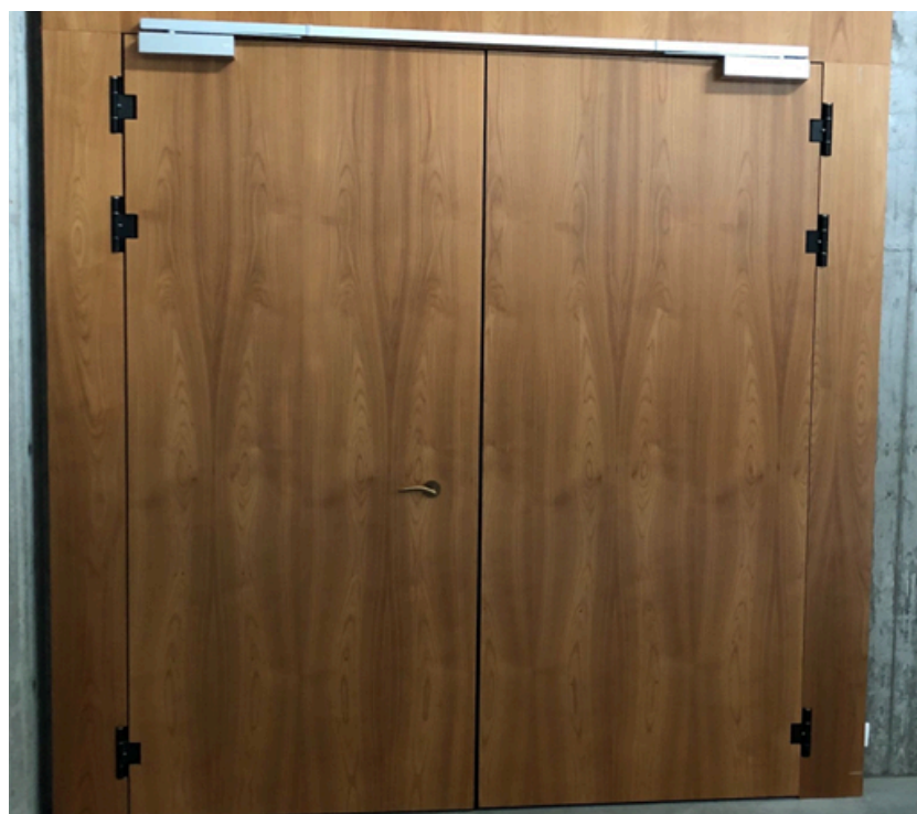
ingang grote zaal (begane grond)
